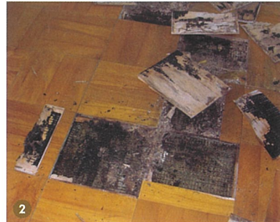
2 直貼りフローアー材にも被害は及ぶ
