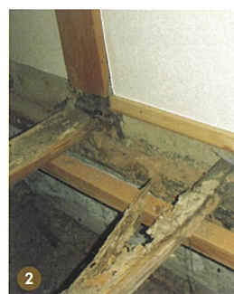
目に見えない床下は被害が進行しやすい
