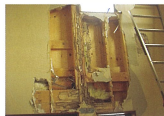
玄関・吹抜けの被害
