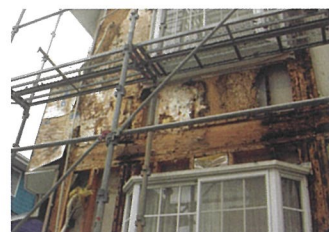
シロアリ被害による大改修
