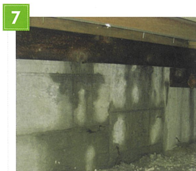
7 風呂場の水漏れからシロアリ発生
