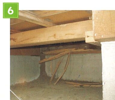
6 コンクリートにも蟻道を作って侵入
