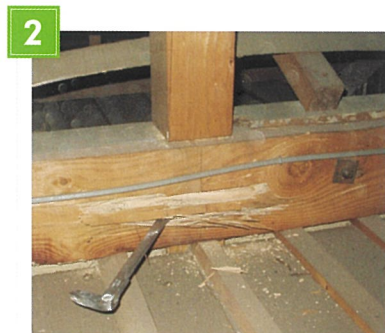
2 屋根裏の被害
