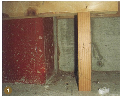
1 鉄骨柱に沿って浸入します
