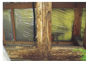
土台・柱の被害
