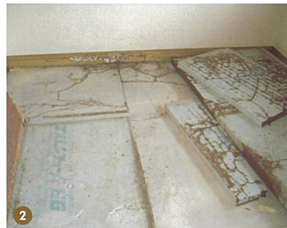
2 和室の断熱材にも被害が及ぶ
