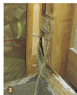
かくれた玄関の柱に被害が及ぶことも
