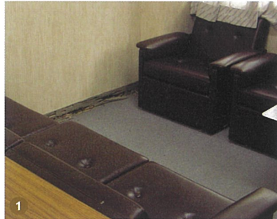
1 框や幅木などの仕上材が被害にあうことも
